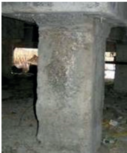
Деструкция II степени. Оголение крупного заполнителя сваи
