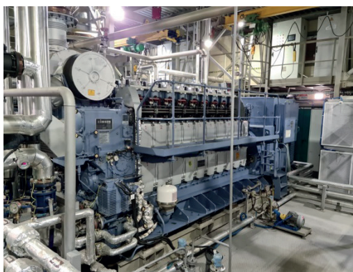
Рисунок 2. Установка HYUNDAI HIMSSEN 9H21/32 (ДГУ)
