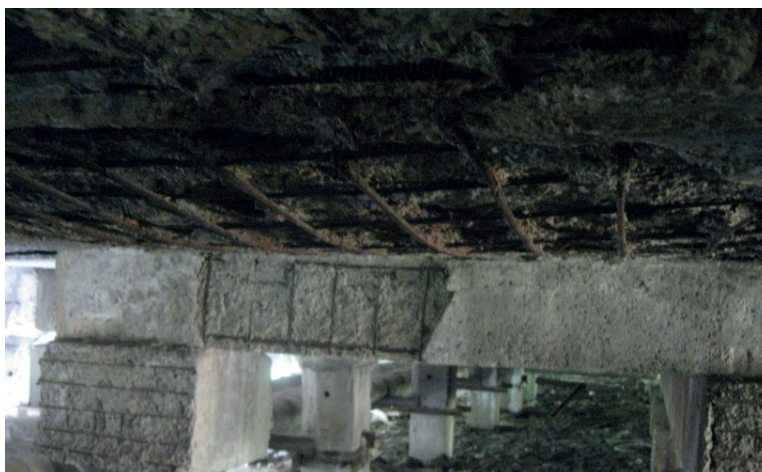
Деструкция 3 степени. Разрушение защитного слоя бетона плиты цокольного перекрытия с оголением и коррозией арматуры. Не обеспечивается сцепление бетона и арматуры. Недопустимый прогиб (5 см) при допустимом 1,9 см.
