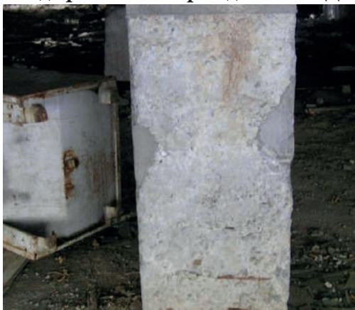
Деструкция бетона 3 степени. Разрушение защитного слоя сваи с оголением и коррозией арматуры
