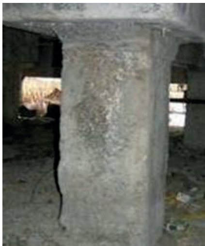
Деструкция II степени. Оголение крупного заполнителя сваи
