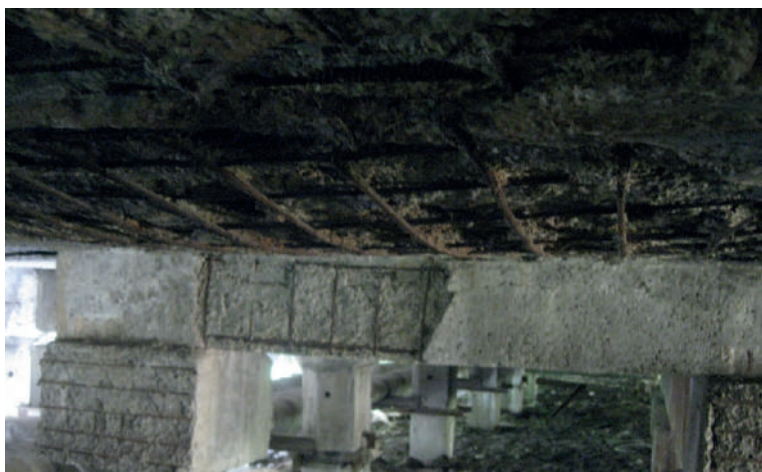
Деструкция 3 степени. Разрушение защитного слоя бетона плиты цокольного перекрытия с оголением и коррозией арматуры. Не обеспечивается сцепление бетона и арматуры. Недопустимый прогиб (5 см) при допустимом 1,9 см.
