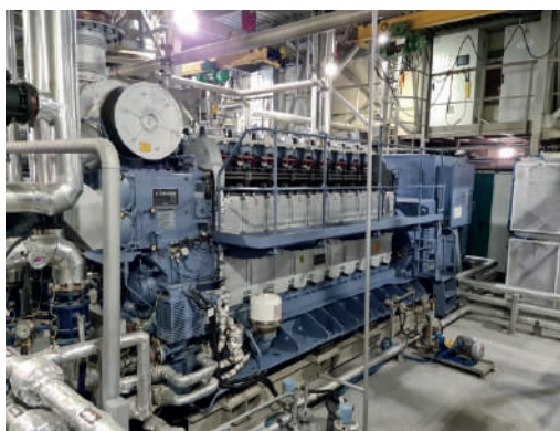
Рисунок 2. Установка HYUNDAI HIMSSEN 9H21/32 (ДГУ)
